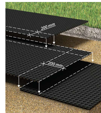
2. По мере укладки рулонов формируйте продольные и поперечные нахлесты, минимальный размер которых 20 см. Торцевые нахлесты следует располагать вразбежку (расстояние между такими соединениями должно быть не менее 500 мм).
